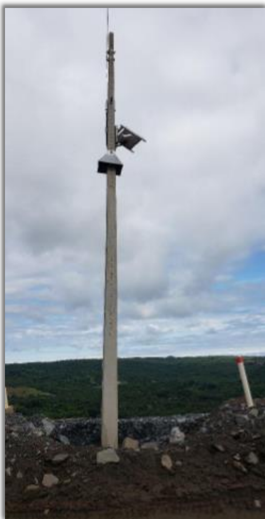
Figura 13-5: Torre de transmissão do sinal dos instrumentos automatizados
