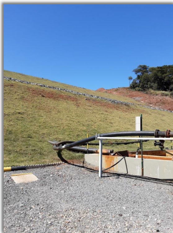
Figura 13-9: Medidor automático de vazão de dreno da barragem instalado junto da calha parshal
