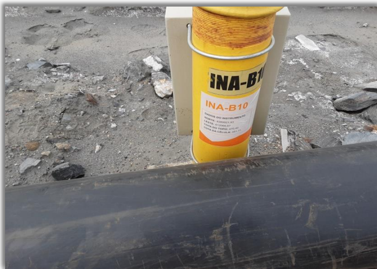
Figura 13-7: Indicador de nível d'água automático instalado no corpo da barragem
