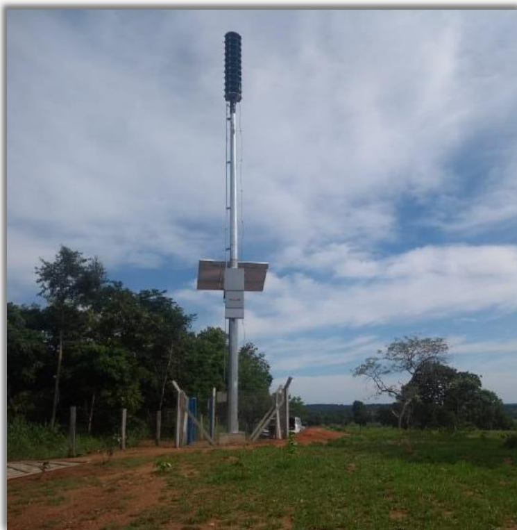
Figura 13-15: Tipo de torre instalada em campo - Sirene 01
