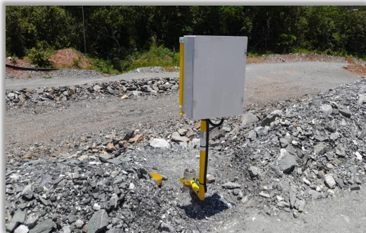
Figura 13-8: Indicador de nível d'água automático instalado no corpo da barragem
