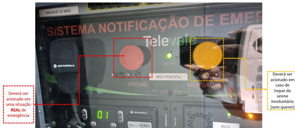
Figura 13-15: Acionamento manual - via botoeiras na sala de comando
