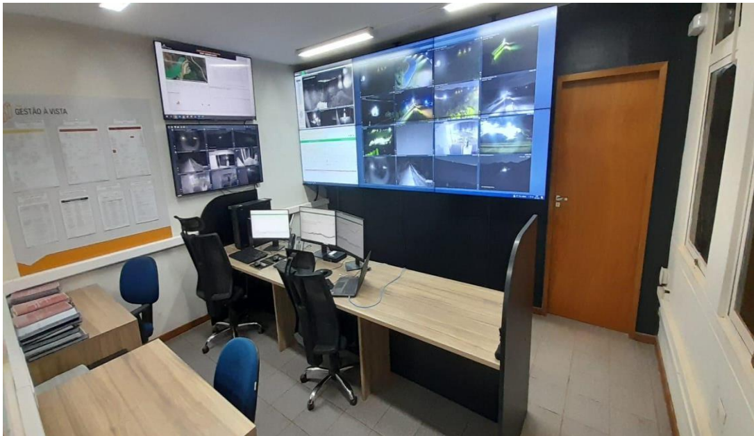
Figura 13-1: Imagem do CMG instalado no prédio da Planta de Queiroz, Nova Lima
