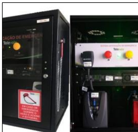
Figura 13-14: Central de Operação Local Externa (COL) e Central de Operação Local Externa Redundante (COL-R)
