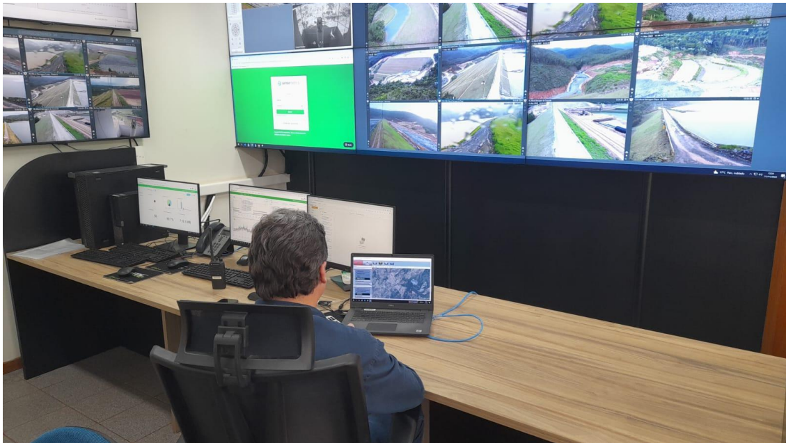
Figura 13-16: Sistema de acionamento das sirenes no Centro de Monitoramento Geotécnico
