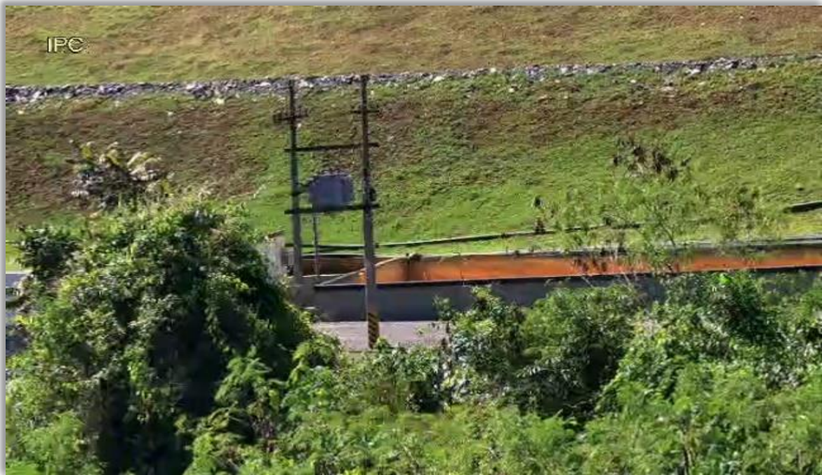
Figura 13-4: Câmera instalada no corpo da barragem para verificação da estrutura a jusante e da fundação da barragem
