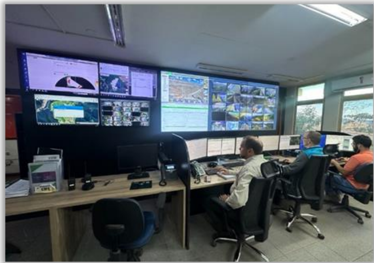
Figura 10: CMG -Centro de Monitoramento Geotécnico de Barragens em operação.
