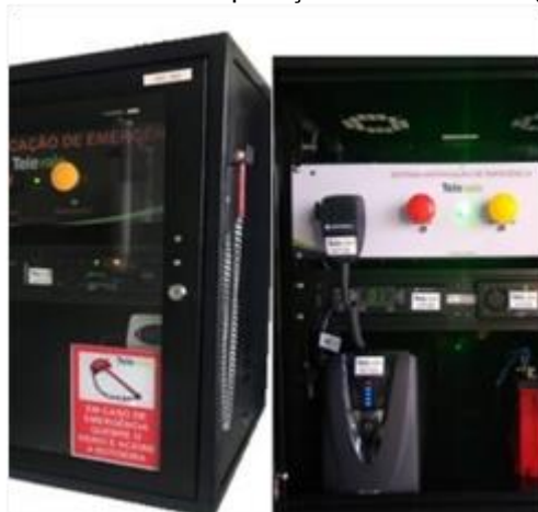
Figura 4: Central de Operação Local Externa (COL)
