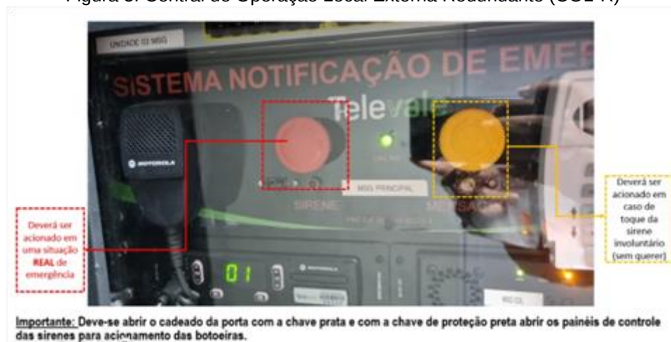
Figura 5: Central de Operação Local Externa Redundante (COL-R)
