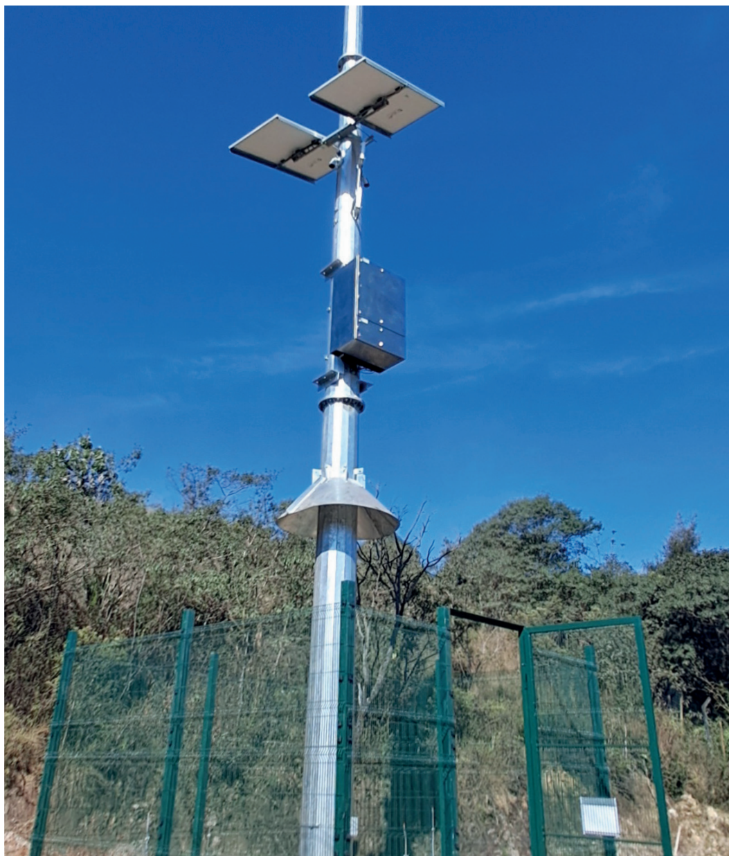
Sistema de sirenes de emergência da barragem da Operação Cuiabá.
