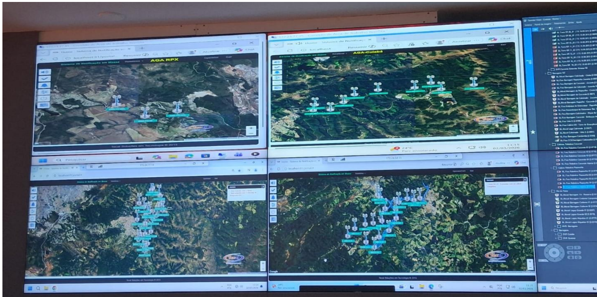
Figura 3: Exemplo da Estação de Operação Remota (EOR)
