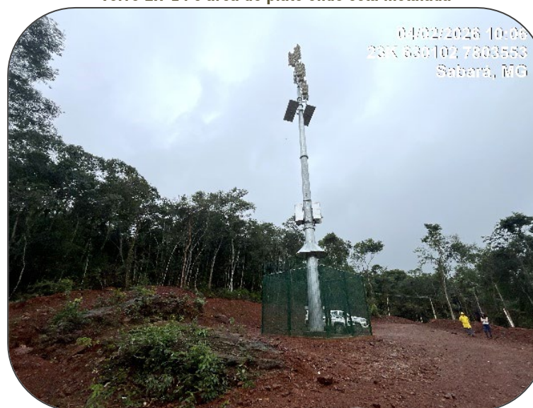
Torre ER-14 e área do platô onde está instalada
